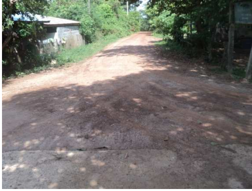
0+000 จุดเริ่มต้นโครงการช่วงที่2 (บ้านผือน้อย)
